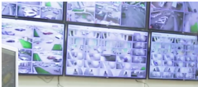
Рисунок 3 - Центр слежения за жилым комплексом «Ньютон безопасность»
